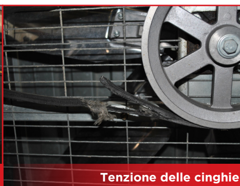
Controllare pulegge e motori
