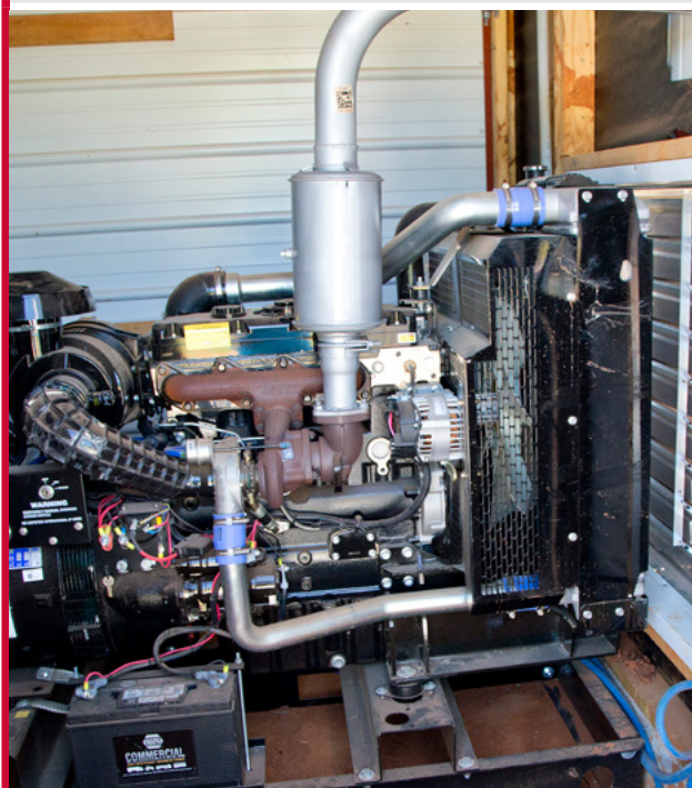
Рисунок 6.2 Пример запасного генератора.
