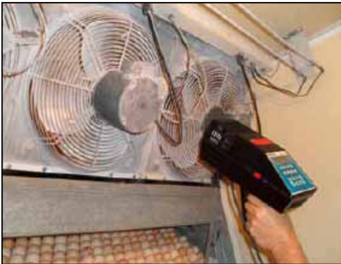
Figura 6: Uso de un estroboscopio para verificar la velocidad de los ventiladores.
